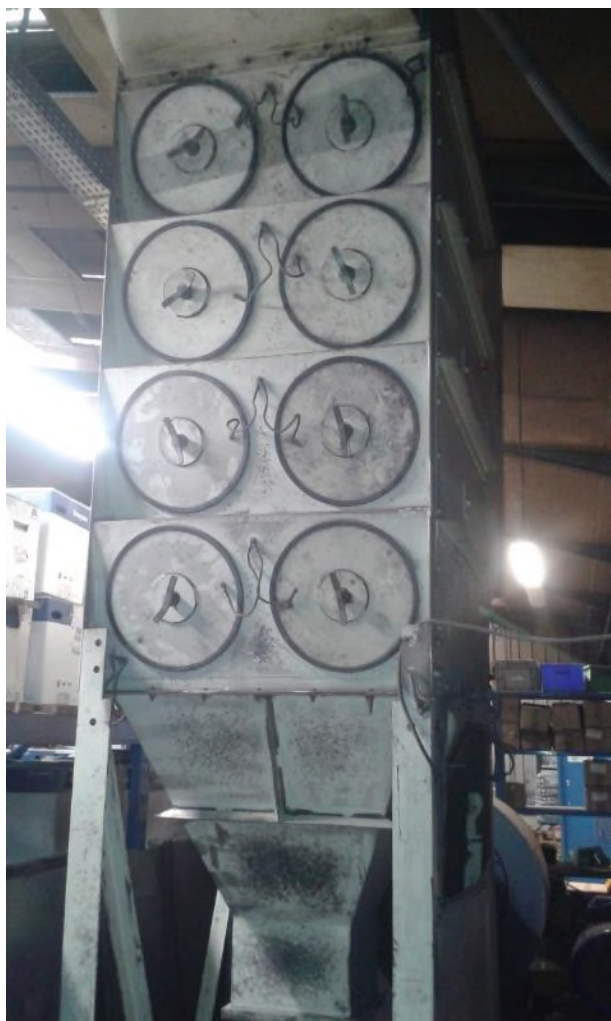
Installation de traitement des rejets atmosphériques
